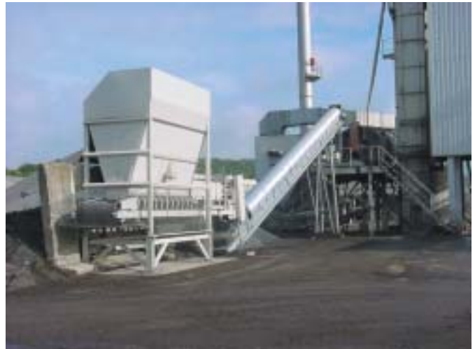
Centrale de fabrication équipée pour le recyclage des agrégats
